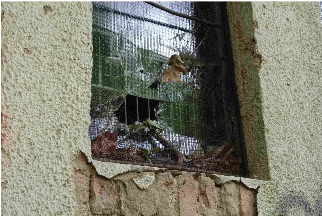
Abb. 7 u. 8: Pavillonartiges Gebäude im Westen des Plangebiets. Zerbrochenes Fenster, durch welches Kleinvögel oder Fledermäuse einfliegen könnten
